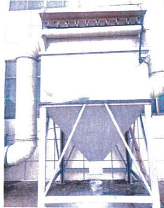
混料粉尘废气处理设施
