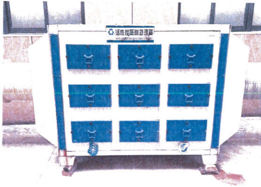
有机废气处理设施
