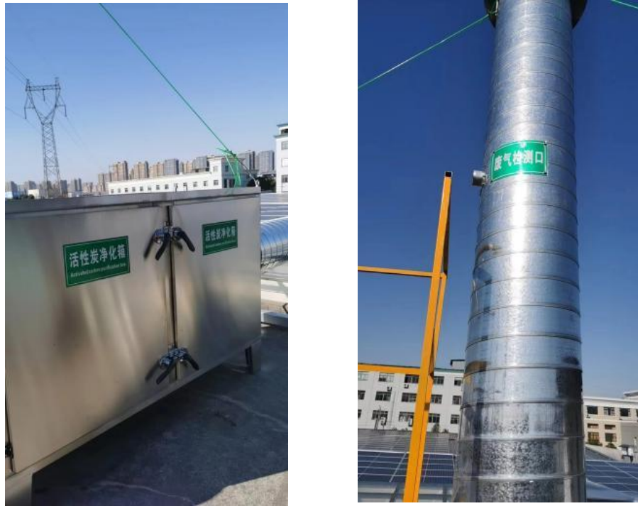
图 4-3 项目废气处理设施照片
