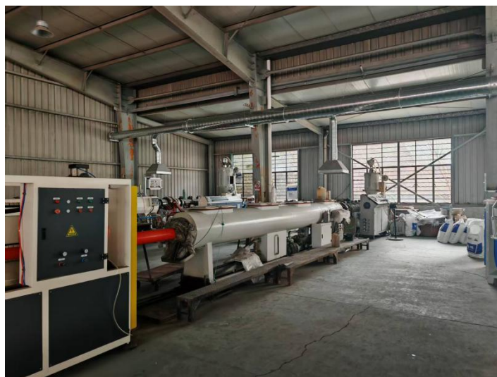
废气收集环节照片
