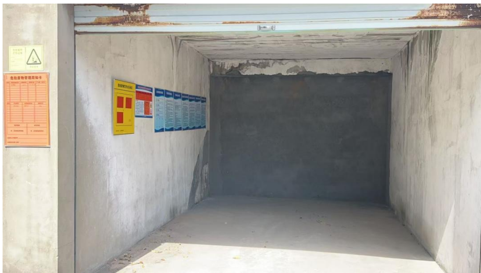
危险废物仓库现场照片
