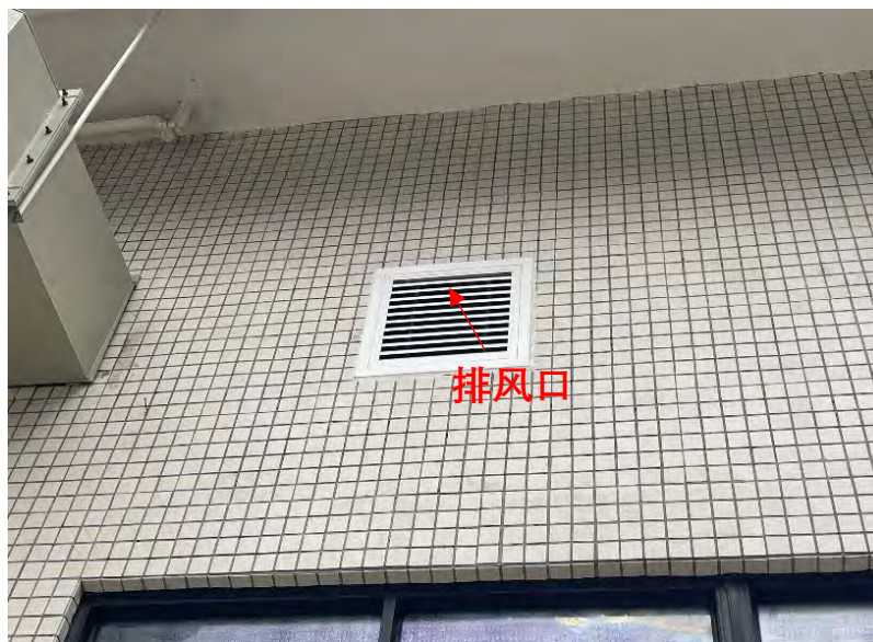
图 4-1 排风口现场照片
