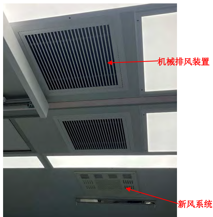
图 4-2 通风换气装置现场照片
