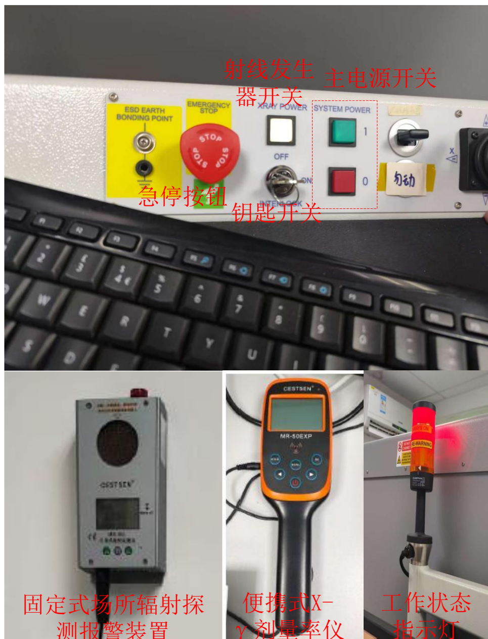
图 10-5 辐射安全设施实物图
