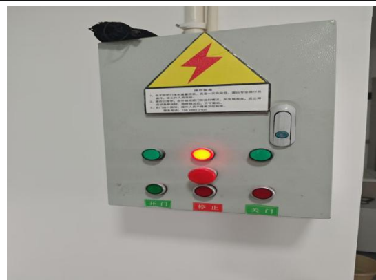
图3-7 防护门外控制装置
