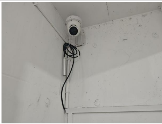
图3-10 隧道监控设备
