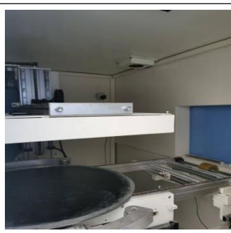
图 2 探伤铅房内部通风装置
