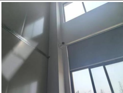
图 3 检测室监控探头
