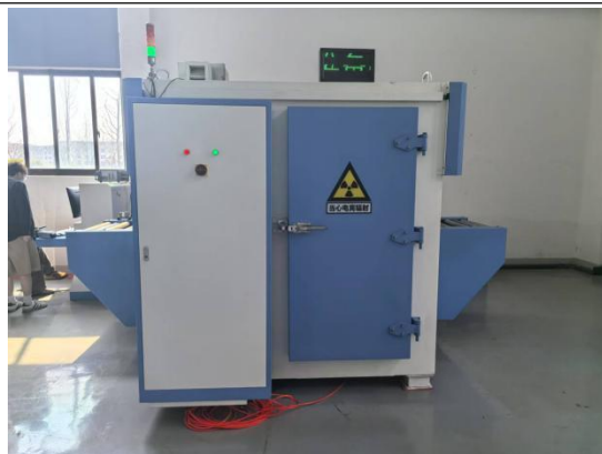
图 9 电离辐射警告标志、警示灯
